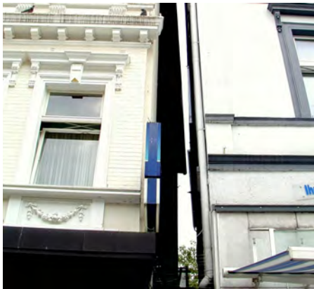
Bild 1 Fassadenansicht (Pfeil zeigt in Richtung Badezimmerfenster)
